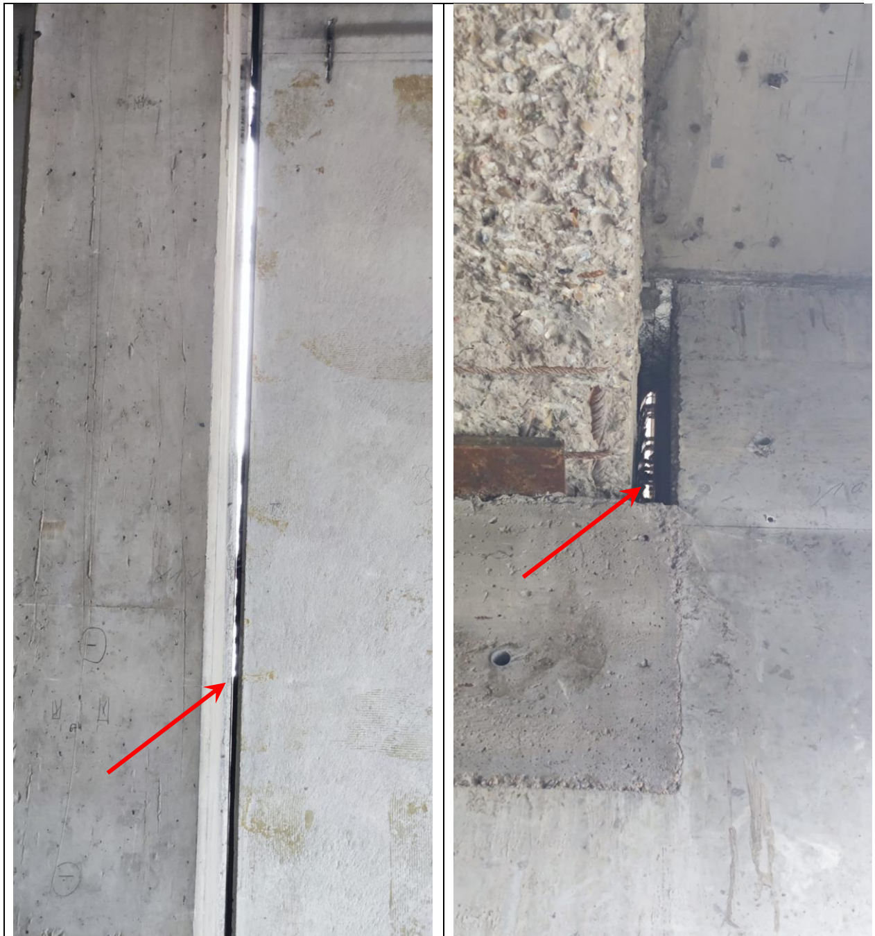
Abbildung 9) Spalten in der Außenwand
