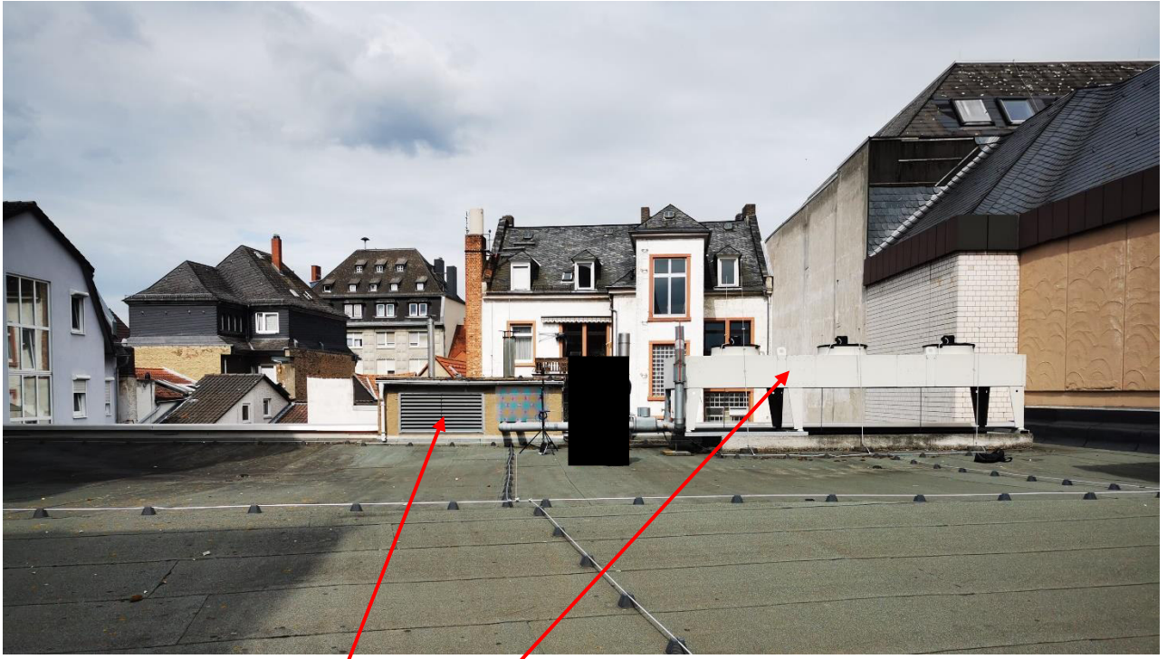
Abbildung 6: Blick auf Lüftungsauslass und Gaskühler; rechts im Bild ehemaliges Kaufhaus JOH
